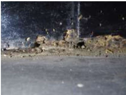
Schade aan de plinten.
